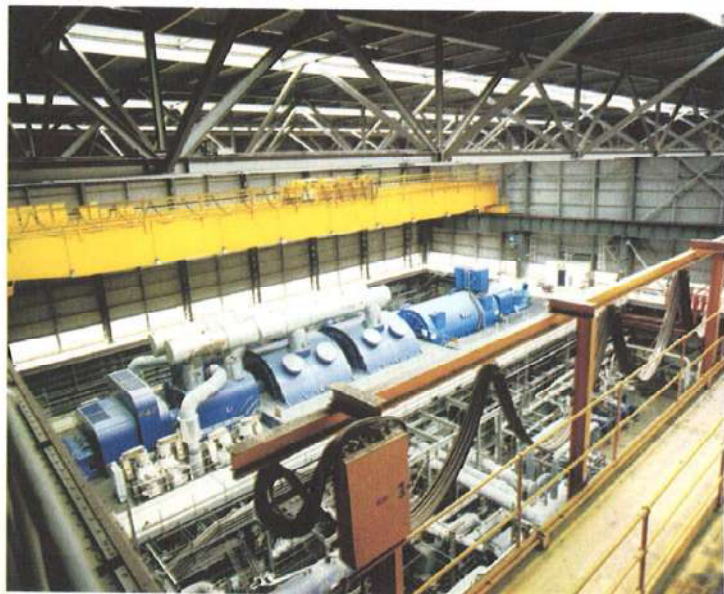
Figura 17.3 Gjeneratorët e një centrali të madh elektrik.
